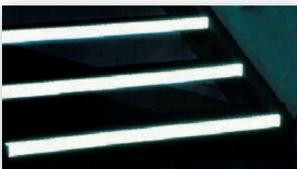
Markierung von Treppenhäusern
